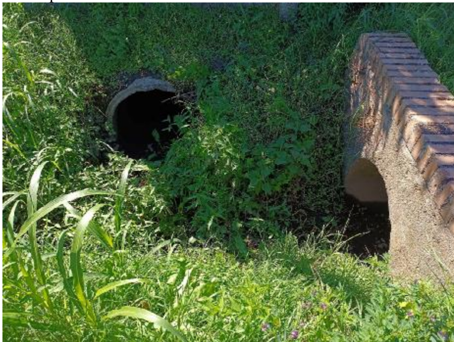
8. Ingresso su fosso Bicocca della condotta cemento diam. 800 proveniente da area artigianale Colombarotto
